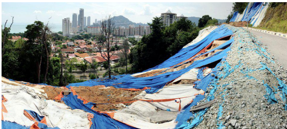
Rajah 9 Kejadian hakisan tanah di Jalan Solok Tanjung Bungah
