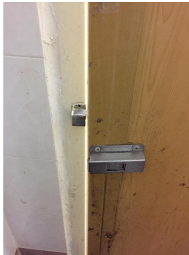
Foto 25: Tombol pintu tandas yang rosak
