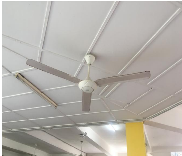
Foto 29: Keadaan kipas yang tidak berfungsi
