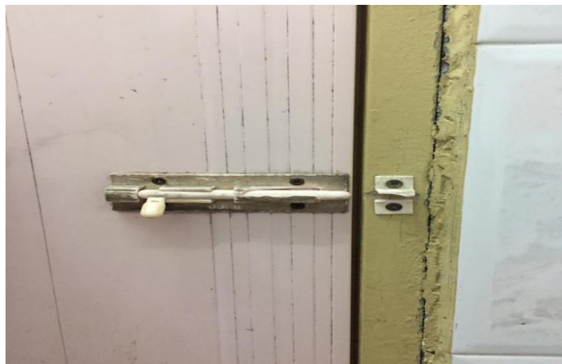
Foto 32: Tombol pintu yang rosak
