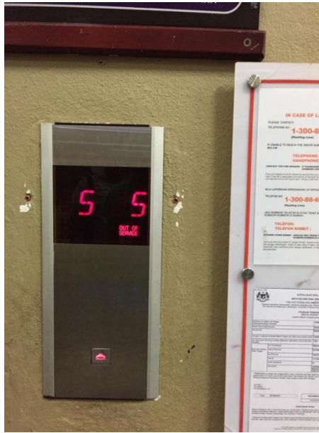
Foto 26: Kerosakkan pada lif yang menunjukkan ‘ Out of Service ’
